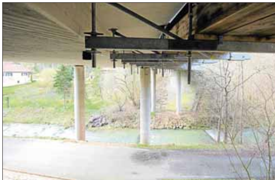
Unter die Brücke gehen: Neue Perspektiven ermöglicht der Gang unter das 40 Jahre Bauwerk, dem eindringendes Wasser schwer zugesetzt hat.
