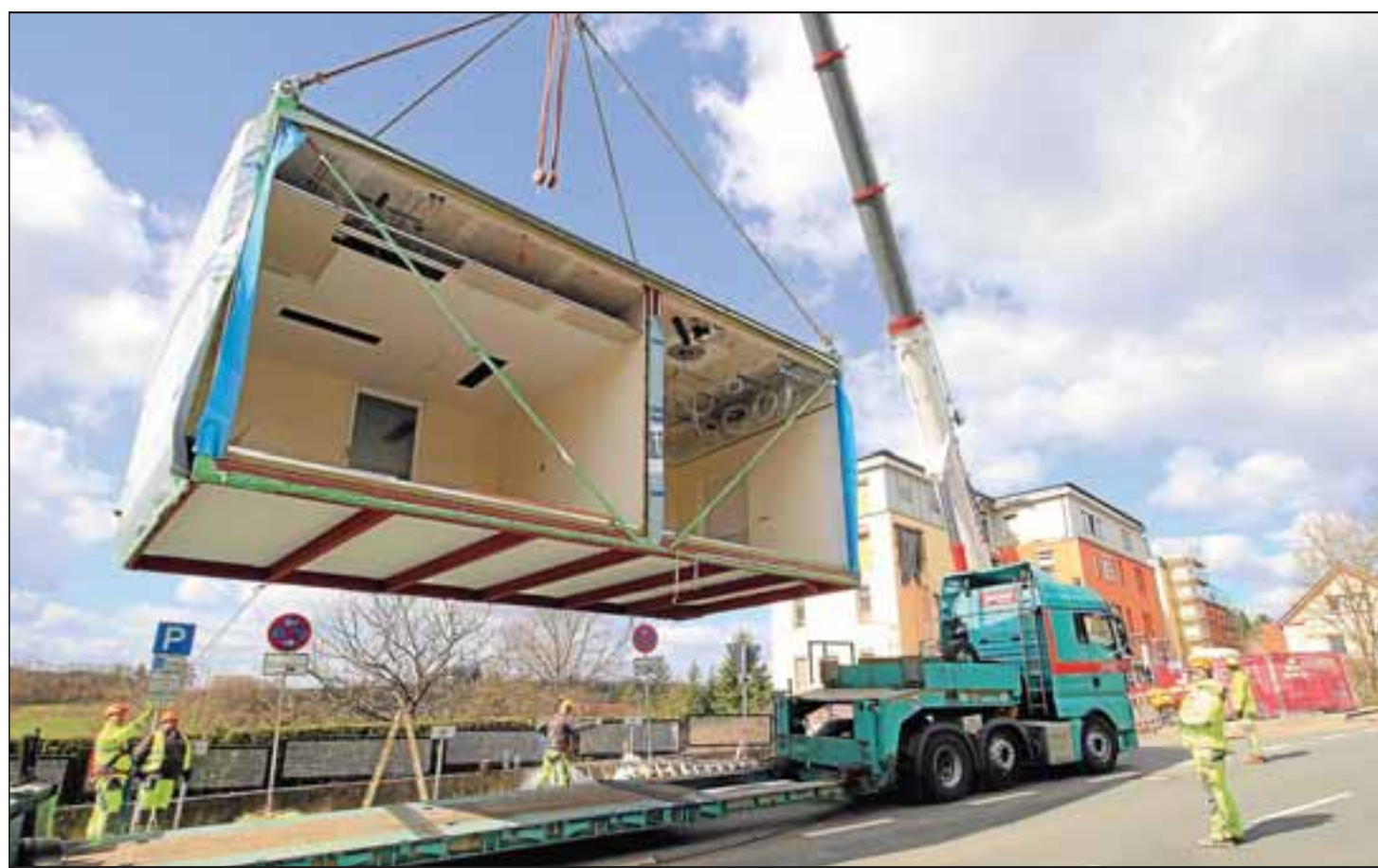
Die bis zu 18 Tonnen schweren Module werden per Kran an ihren Bestimmungsort gebracht. Alle Fotos: Rüdiger Busch
