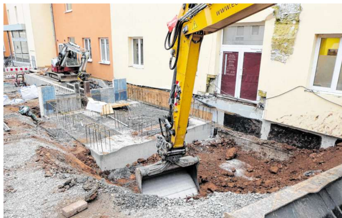
Die Bauarbeiten am Hardheimer Krankenhaus gehen zügig voran. Zurzeit werden die Fundamentarbeiten (Bild) ausgeführt. Gleichzeitig wurde die Plattform für den neuen Personenaufzug betoniert.
