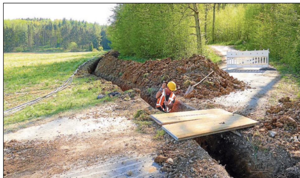
Seit Kurzem laufen die Arbeiten zur Verstärkung des Stromnetzes zwischen Hardheim und Höpfingen. Unsere Aufnahme entstand in der Nähe des Erfelder Sees. Foto: Rüdiger Busch
